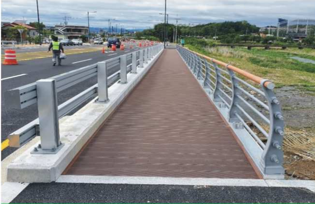
보강설비가 구비된 확장인도(교량/옹벽)
